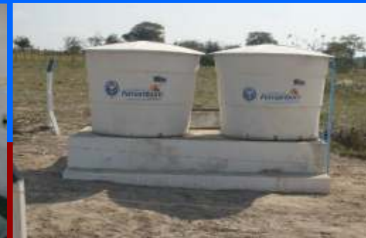
Reservatórios de distribuição de água
